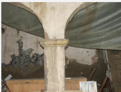
MURO DE ADOBE CON EROSIÓN FÍSICA
