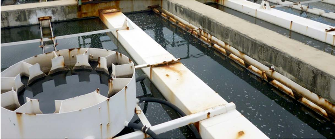
Figura 7.40. Aspecto de un RAFA a los siete años de operación por una mala selección de la calidad de los materiales constructivos (Wagner, 2018).
