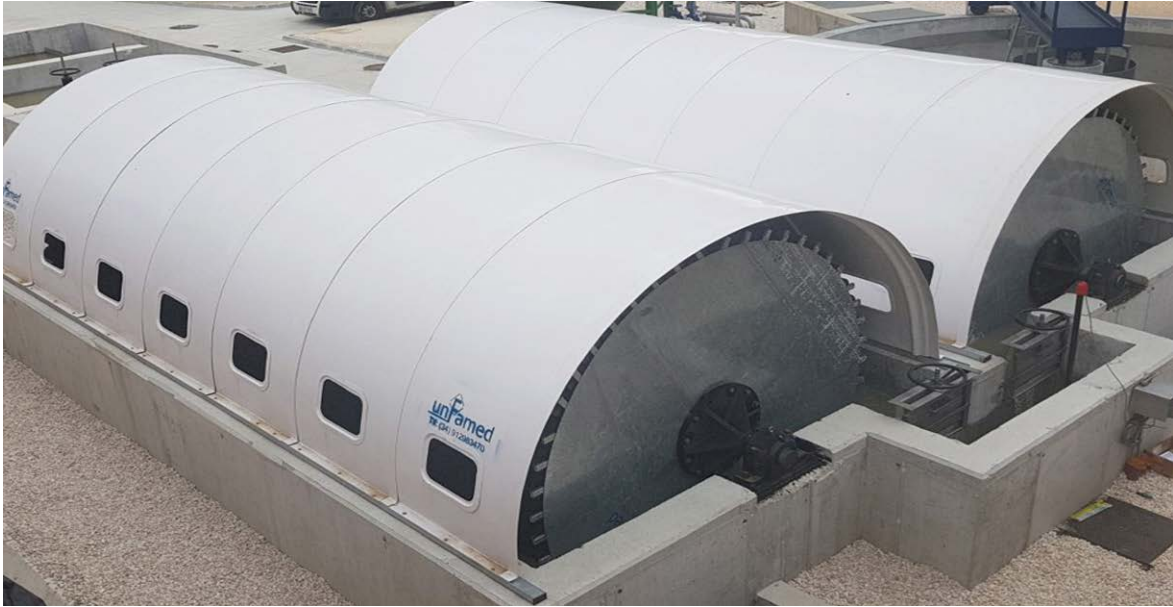
Figura 7.152. Contactor Biológico Rotativo. (PTAR de Laguna de Negrillos, León, España) (UNFAMED).
