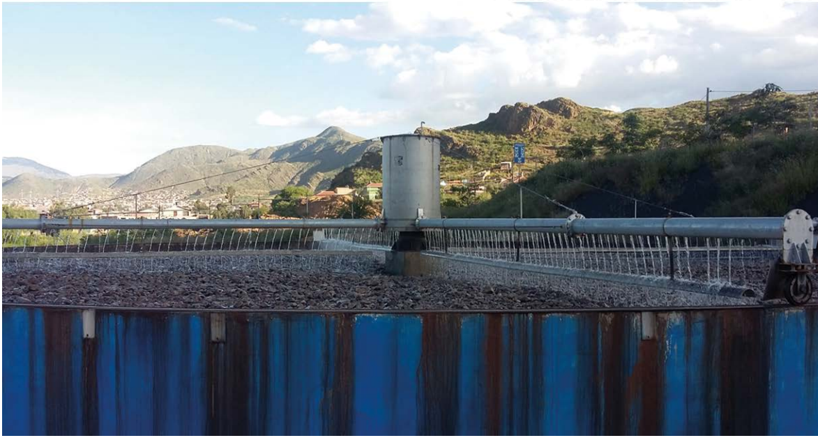
Figura 7.146. Filtro Percolador con sistema de distribución móvil por carga hidráulica (PTAR El Abra, Sacaba, Bolivia).
