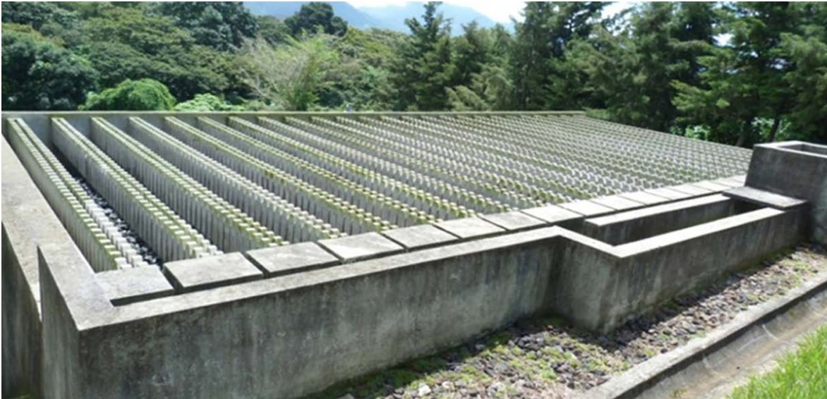
Figura 7.145. Filtro Percolador con sistema de reparto fijo.
