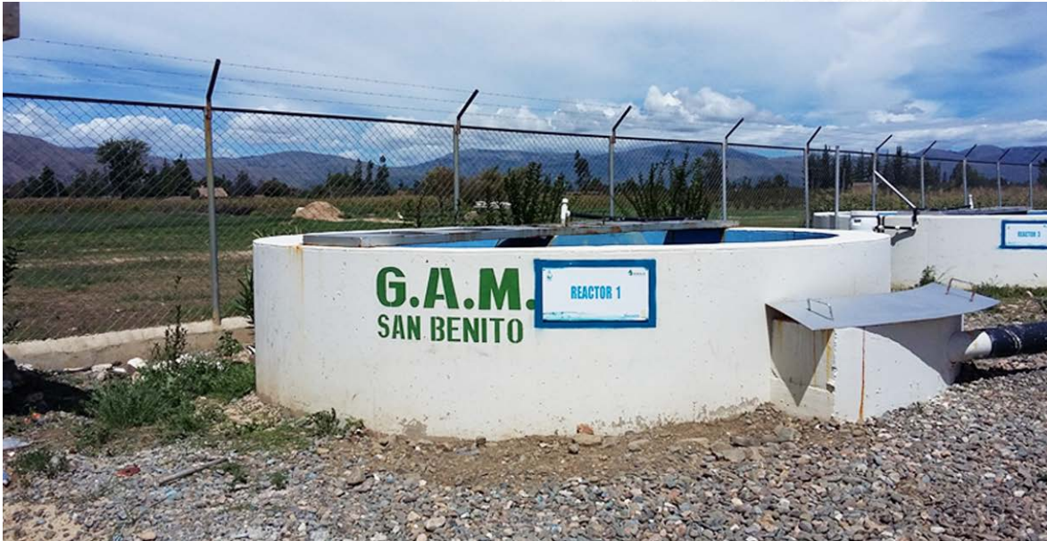
Figura 7.18. Reactores Anaerobios de Flujo Ascendente en la PTAR de Linde Paracaya (Bolivia).
