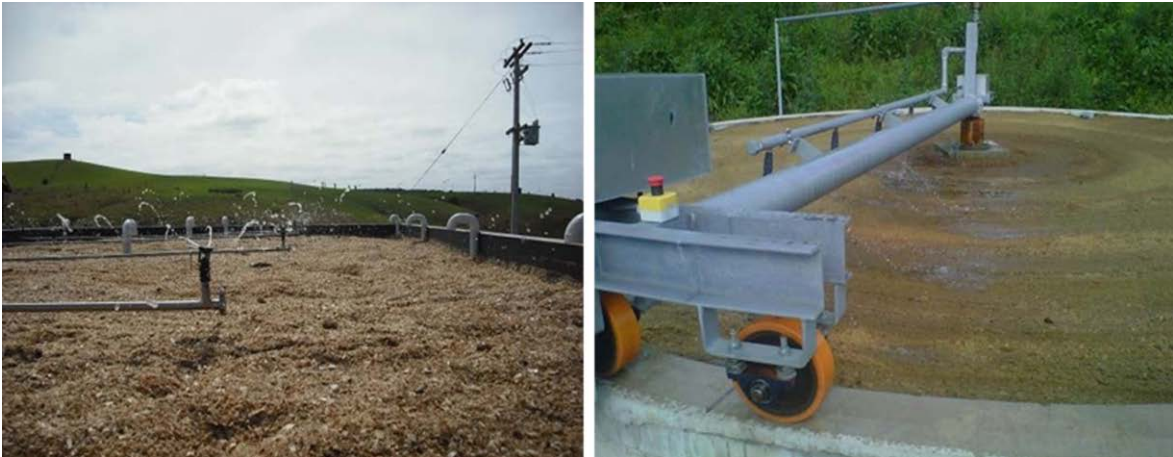
Figura 7.102. Riego de Lombrifiltros mediante aspersores y mediante un brazo de distribución giratorio (BIDATEK).
