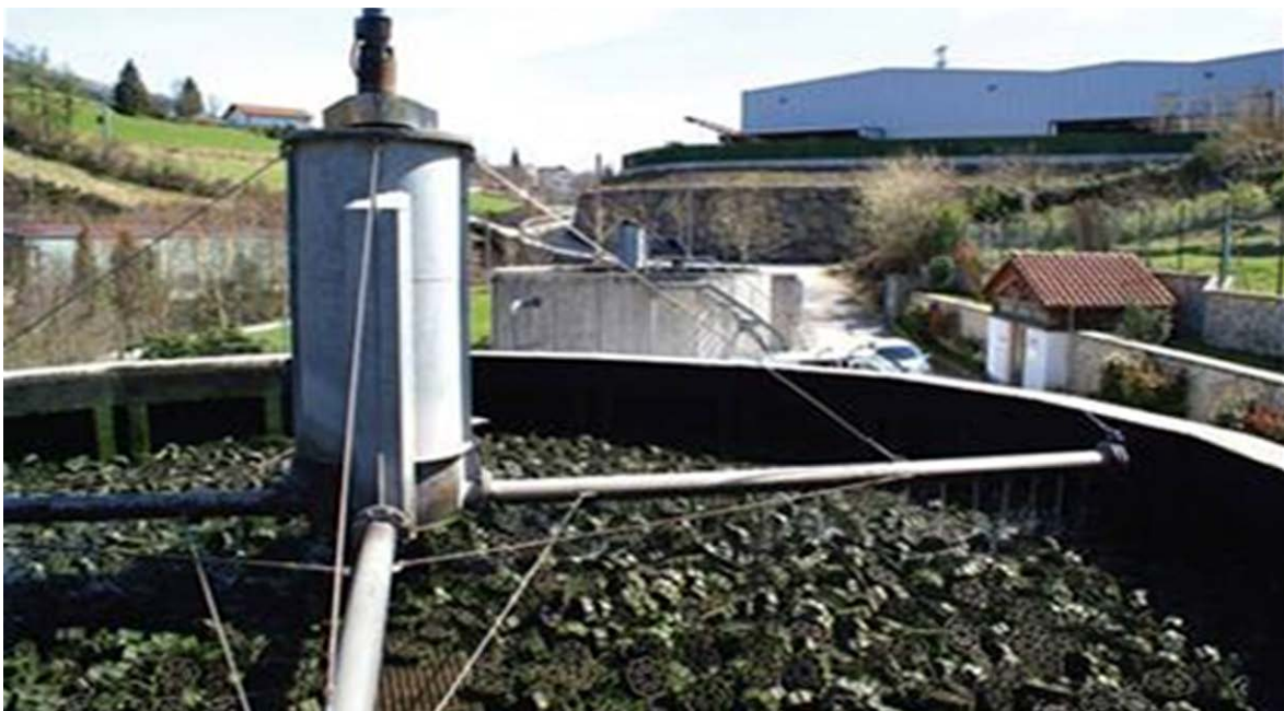
Figura 7.147. Filtro Percolador con sistema de distribución móvil motorizada.
