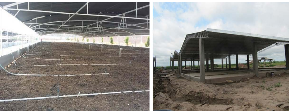
Figura 7.100. Protección de un Lombrifiltro mediante una malla de sombra (BIDATEK) y techumbre de la PTAR Fernández Alonso (Santa Cruz, Bolivia).
