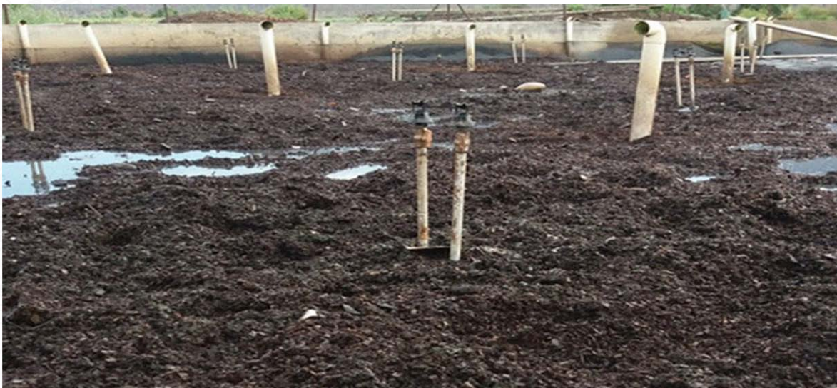
Figura 7.86. Lombrifiltro en la PTAR de Saipina (Santa Cruz de la Sierra, Bolivia). Se observan los aspersores para la distribución de las aguas y las tuberías de ventilación.
