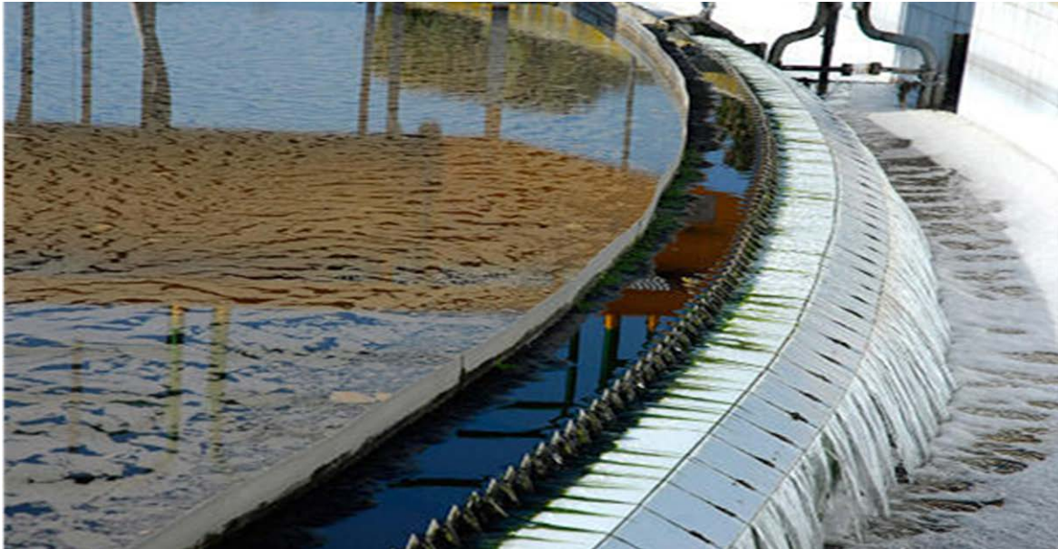
Figura 7.149. Detalle del deflector y del vertedero Thompson a la salida de un sedimentador secundario.
