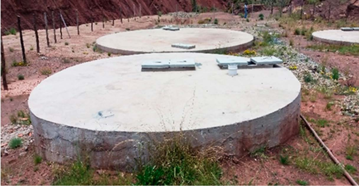
Figura 7.2. Tanque Séptico y Filtro Anaerobio de Flujo Ascendente (PTAR de Corocoro, La Paz, Bolivia).
