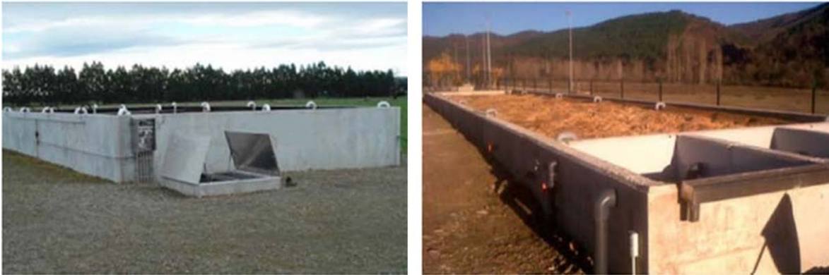
Figura 7.99. Lombrifiltros construidos en superficie y semienterrado (BIDATEK).
