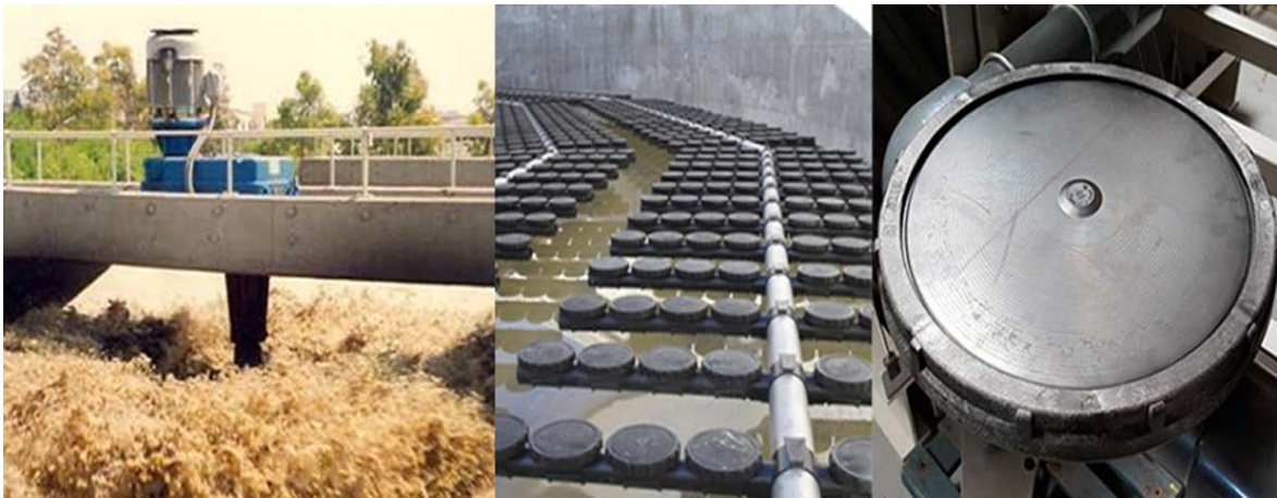
Figura 7.181. Aireación mecánica y mediante difusores.
